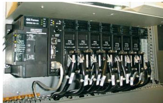
Rys.1. Widok sterownika układu wyprowadzenia mocy generatora w Elektrowni Skawina wyposażonego w moduły MDL655 połączone z separatorami SI, co umożliwiła podłączenie 224 sygnałów wejściowych
