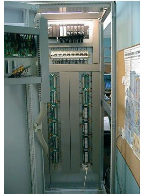
Rys. 2. Wnętrze szafy sterownika układu elektrycznego generatora nr 6 w Elektrowni Konin z zabudowanymi separatorami rodziny ET
